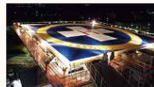
ヘリポート照明システム
