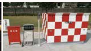
ヘリポート給油設備
